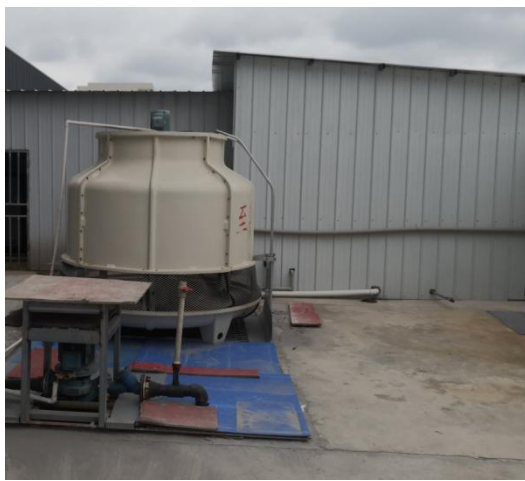
冷却塔及循环水池
