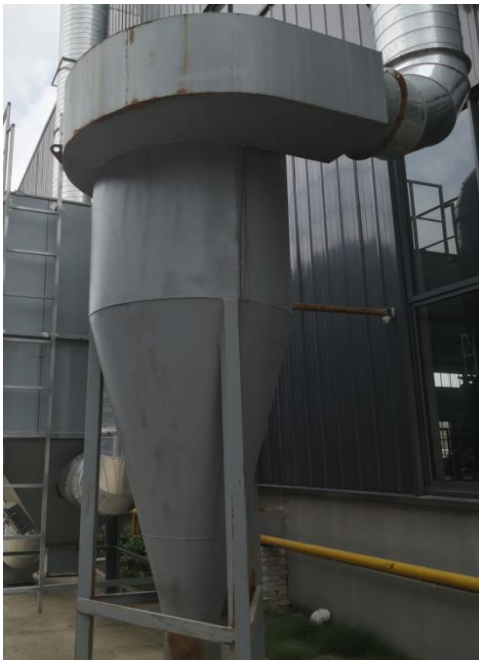
旋风除尘设施
