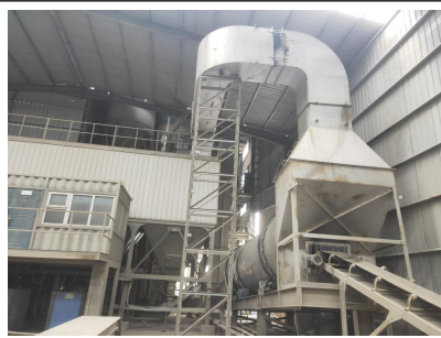
粉尘集气管道
